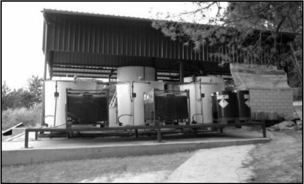
Planta semi-industrial situada en Baeza (Jaén) para la depuración de aguas residuales de la producción de aceite de oliva y del lavado de la aceituna mediante proceso Fenton.
