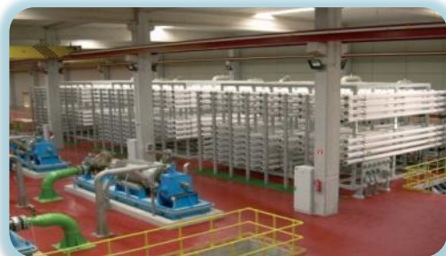
Desaladora de Valdelentisco (Murcia)
