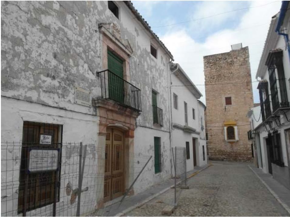
Fig. 2.—Casa familiar de Juan Valera en Doña Mencía; como puede comprobarse se encuentra muy deteriorada. (Fotografía de Juan Manuel Barrios Rozúa, 2012).
