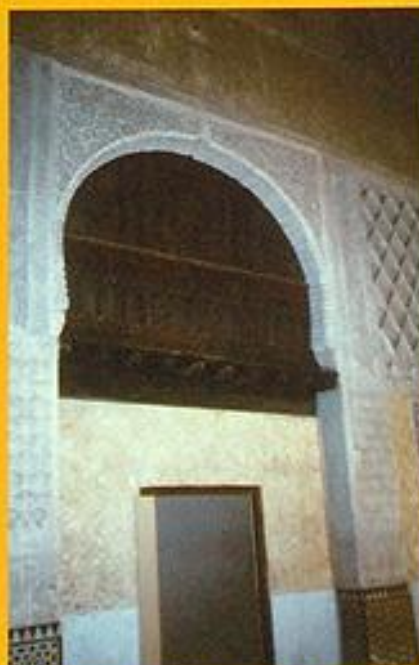
La alhanía cegada antes de la restauración.
