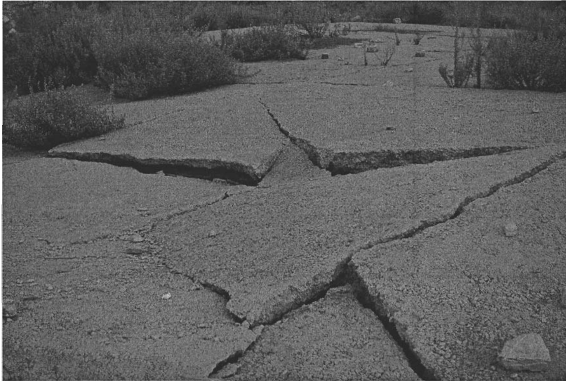
Foto 1: Toda la losa de hormigón que cubre la superficie del antiguo cementerio está completamente partida.
