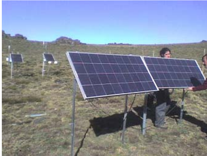
Fig 2.9. Orientación Norte. Paneles de alimentación de la torre de flujos
