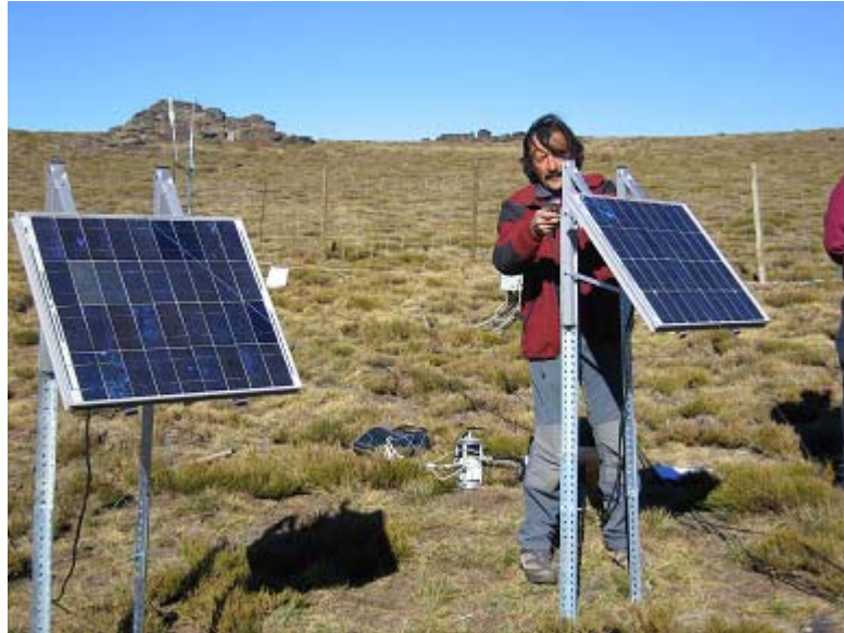
Fig 2.7. Paneles de alimentación de las torres SN323 y SN324
